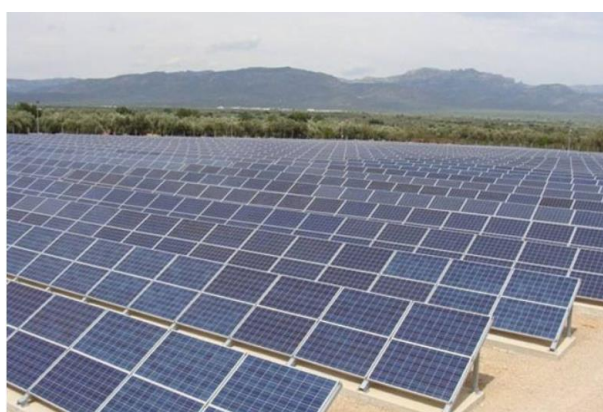
Fig.22 – Parc fotovoltaic Livada, jud. Satu-Mare
