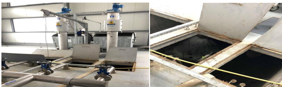
Fig.1. Pompe active care funcționează în cascadă, pentru introducerea apei în stația de epurare
